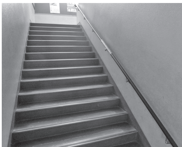
階段手すりのぐらつきは危険（駒小南校舎）
