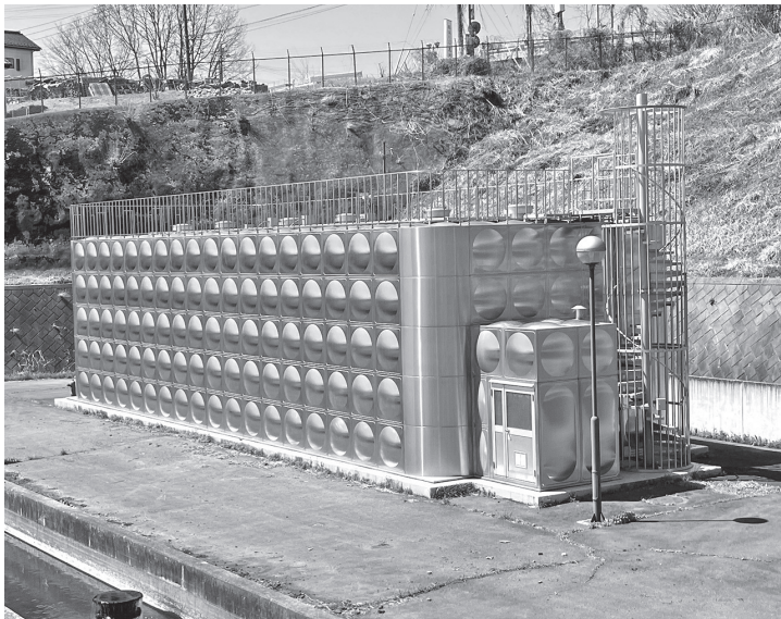
安心安全で廉価な水の供給が第一（新幹線トンネル水原水調節井）
