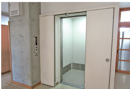
駒寄小エレベーター
